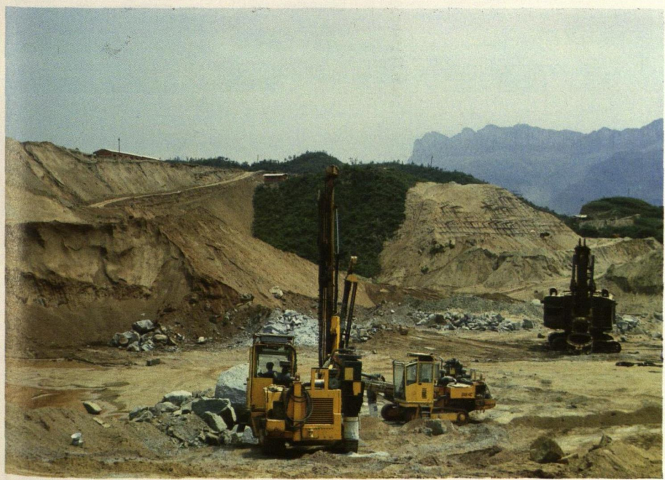
Anläggningsarbetena vid det kinesiska kraftverksbygget Three Gorges påbörjades under 1994 med hjälp av ett stort antal borrhjuggar från Atlas Copco.
