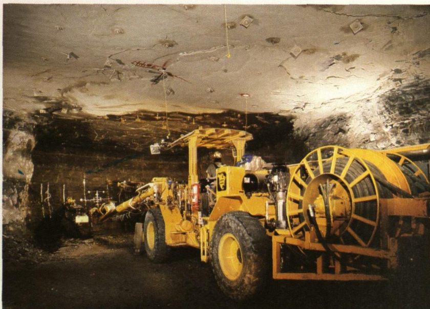
Borrhiggregat för ortdrivning utrustat med den nytvecklade lätta hydraulbommen.
