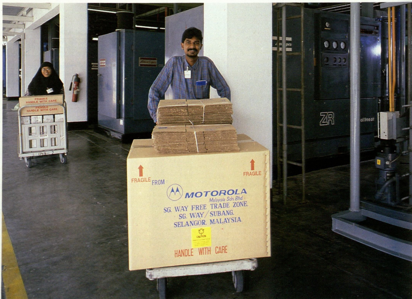
Till Motorolas elektronikindustrier i Kuala Lumpur, Malaysia, har Atlas Copco levererat kompressorcentralen. De oljefria kompressorena är utrustade med energiåtervinning.
