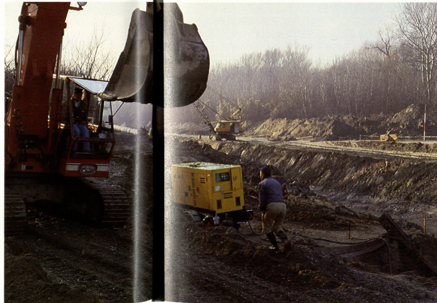
Dieseldrivna generatorer introducerades under året för att erbjuda transportabel energi på byggarbetsplatser för bl a belysning, svetsning, drift av pumpar, motordrivna spett och andra verktyg. På bilden används generatoren som energikälla vid den österrikiska delen av pipelinebygget för naturgas mellan Sovjetunionen och Italien.
