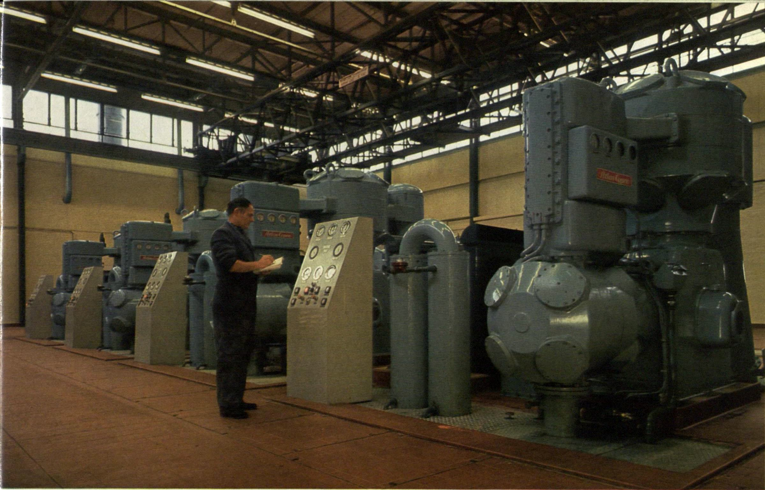
Dessa Atlas Copco-kompressorer utgör en del av tryckluftanläggningen vid en av Vauxhalls fabriker i England.
